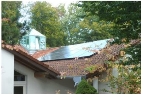
Eins der beiden Solarmodul-Felder auf dem Dach der KiTa Sonnenschein
